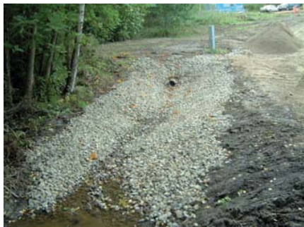
Dagvattendike på Hedlandet.
